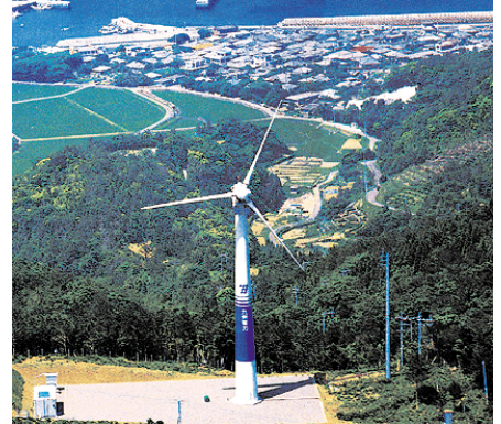
(c)C風力発電所
