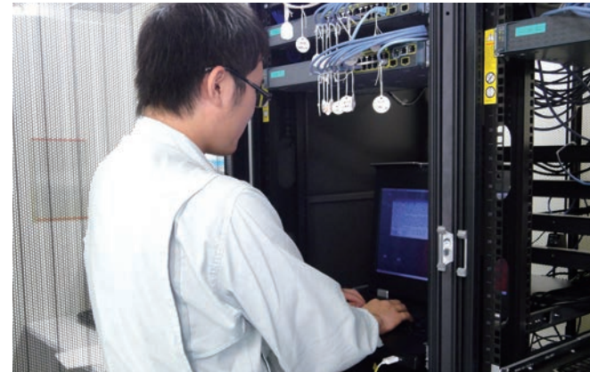
システムのメンテナンス状況
